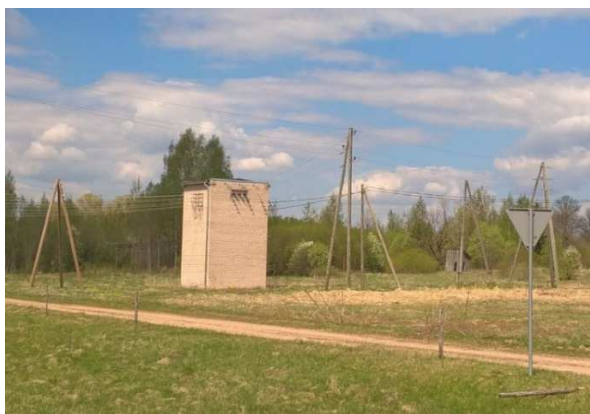
32. attēls "Transformatora apakšstacija pie Tikaiņos" (foto 19.05.17.)
