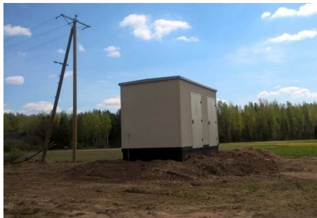
31. attēls "Transformatora apakšstacija pie Rugājiem" (foto 19.05.17.)
